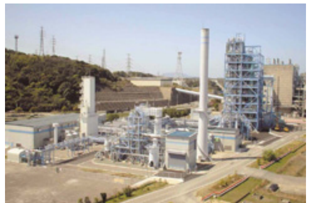
EAGLEパイロットプラント試験設備 (福岡県北九州市)
