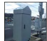
避難経路等に設置
