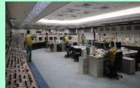
運転員の重大事故対処訓練
