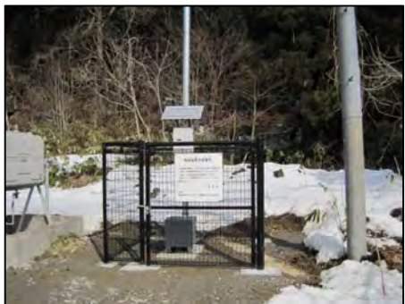
電子線量計【40局】 (非常用電源装備)
