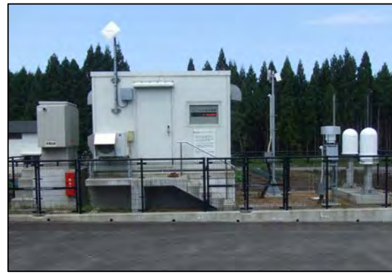
広域モニタリングポスト【12局】 (非常用発電機装備)
