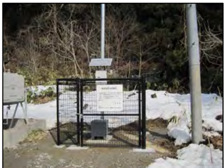
電子線量計【40局】 (非常用電源装備)
