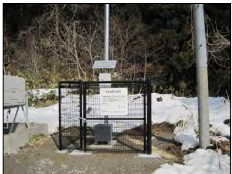
電子線量計【40局】 (非常用電源装備)
