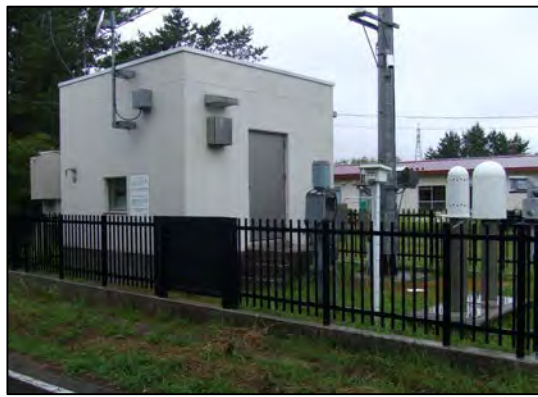
モニタリングステーション・ポスト【13局】 (非常用発電機装備)
