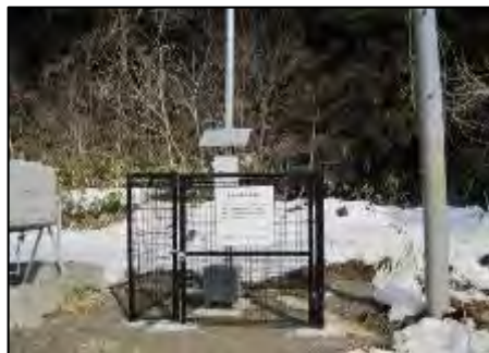
電子式線量計【39局】 （非常用電源装備）
