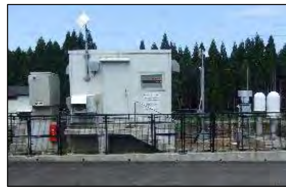
モニタリングポスト【21局】 （非常用発電機装備）
