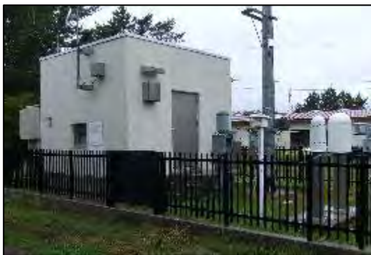
モニタリングステーション【9局】 （非常用発電機装備）
