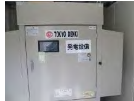
非常用発電機装備(モニタリングステーション)
