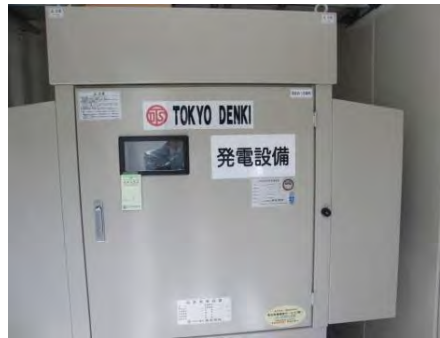
非常用電源設備(モニタリングステーション)
