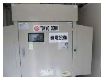
非常用電源装備(モニタリングステーション)
