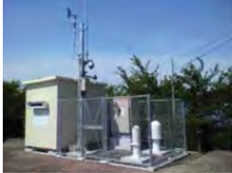
モニタリングステーション【1局】、モニタリングポスト【19局】 (非常用電源装備)
