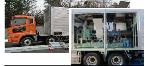
ガスタービン発電機車 (高台配備)
