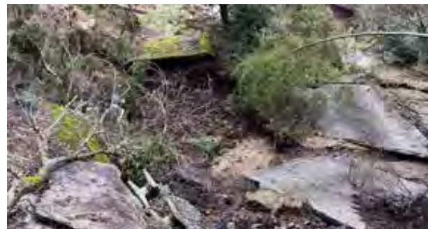
道路の被害状況
