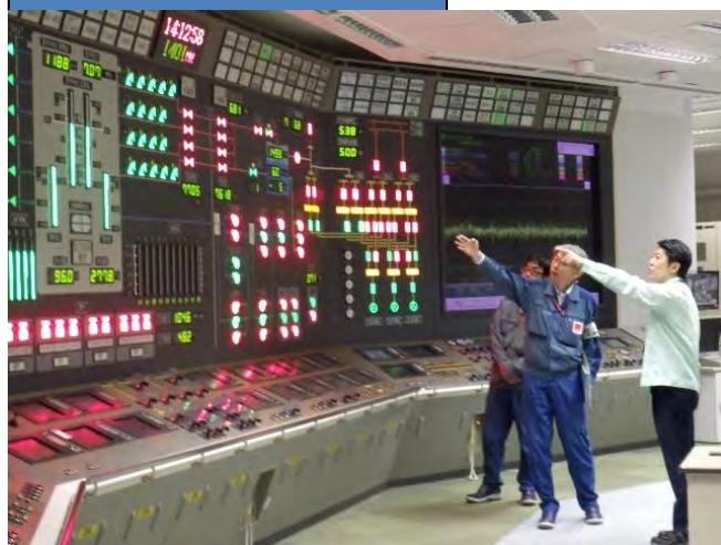
6号機中央制御室
