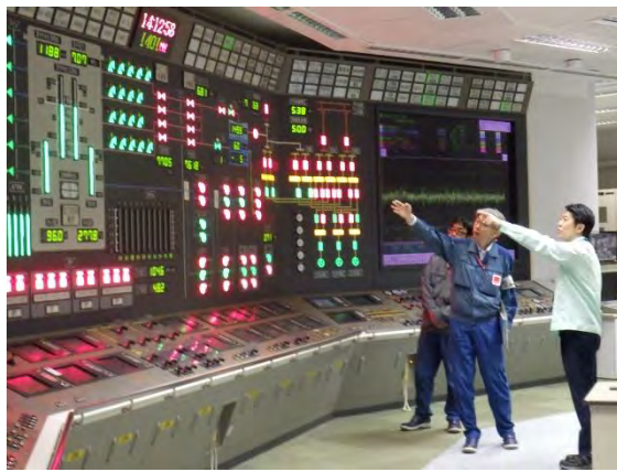
6号機中央制御室
