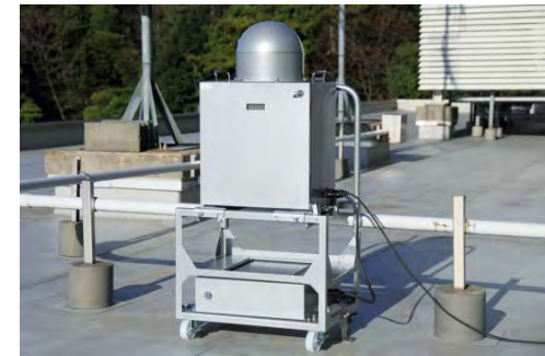
可搬型モニタリングポスト (バッテリー付)【18台】
