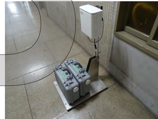
可搬型モニタリングポスト【12台】
