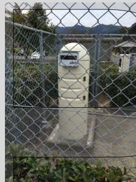
簡易型電子線量計観測局 (バッテリー付)【55局】
