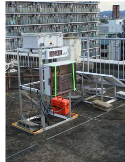
可搬型モニタリングポスト 【5台】 (太陽光パネル+バッテリー付)
