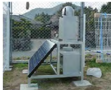
モニタリングポスト【25局】 (ソーラ発電、蓄電池装備)
