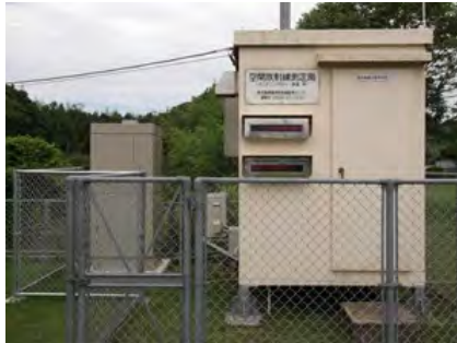
モニタリングポスト【42局】 (非常用発電機装備)
