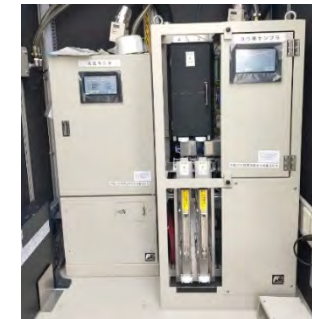
大気モニタ【22台】、ヨウ素サンプラ【6台】 (非常用発電機装備)
