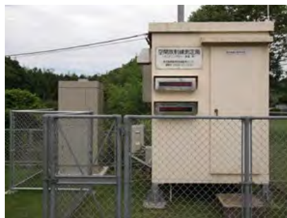
モニタリングポスト【36局】 (非常用発電機装備)
