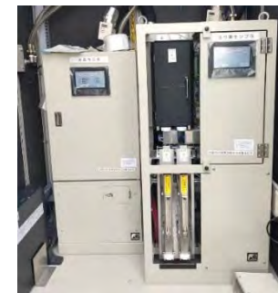
大気モニタ【22台】、ヨウ素サンプラ【6台】 (非常用発電機装備)
