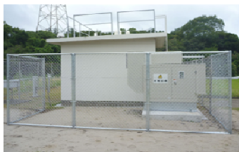
モニタリングステーション と非常用発電機【2局】
