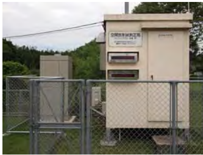
モニタリングポスト【42局】 (非常用発電機装備)
