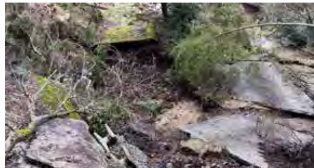
道路の被害状況
