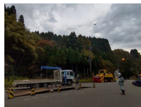
ドローンによる被災箇所の確認
