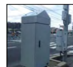
避難経路等に設置
