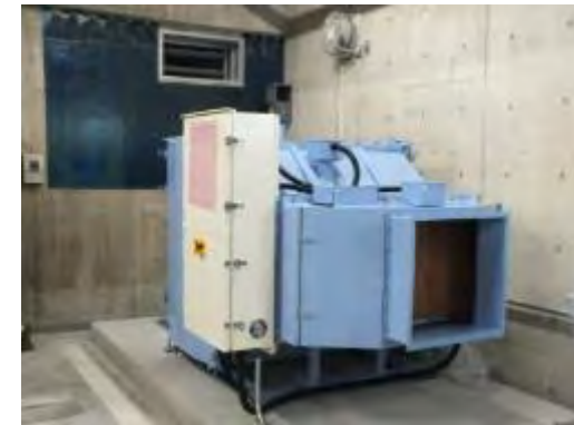
オフサイトセンターに設置された非常時外気取り入れユニット
