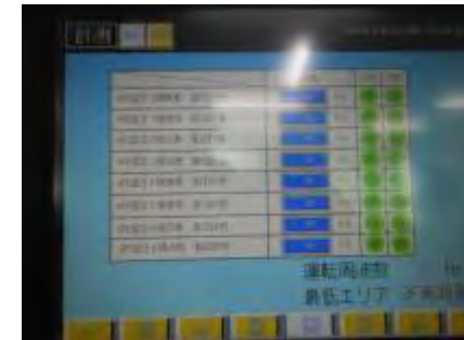
島根県庁における稼働訓練（陽圧化により防護区画は全て30Pa超）
