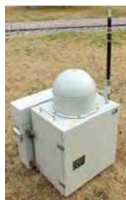
可搬型モニタリングポスト (常設、蓄電池装備)
