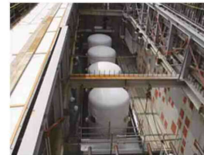
フィルタ付ベント設備
