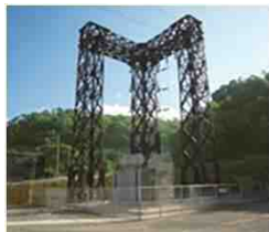
緊急用開閉所
