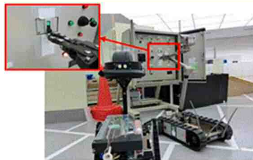
制御盤を開放しスイッチ操作
