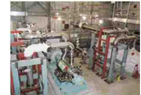
低圧原子炉代替注水ポンプ
