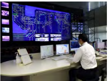
信号機の遠隔制御に係る情報伝達及び手順状況
