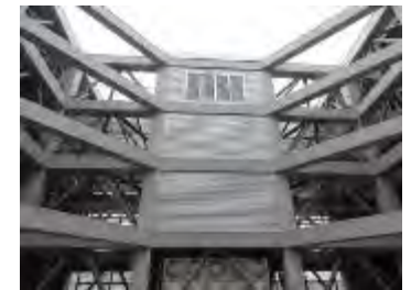
島根県庁に増築された非常時外気取り入れユニットの格納建屋
