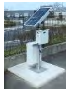
簡易型モニタリングポスト (常設、太陽光パネル装備)
