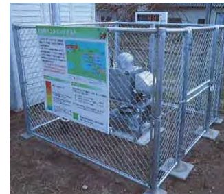
可搬型モニタリングポスト (常設、蓄電池装備)
