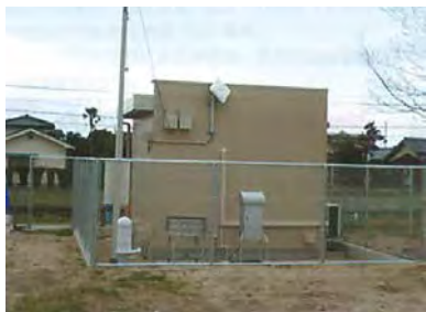
モニタリングステーション (非常用発電機装備)
