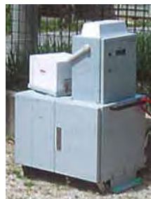
可搬型モニタリングポスト (常設、蓄電池装備)
