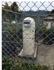
簡易型電子線量計観測局 【55局】 (バッテリー付)
