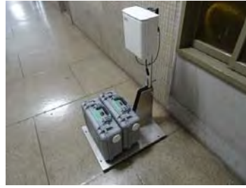
可搬型モニタリングポスト【12台】
