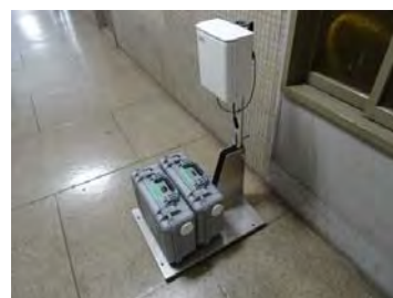
可搬型モニタリングポスト【12台】
