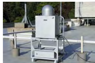
可搬型モニタリングポスト【18台】 (バッテリー付き)
