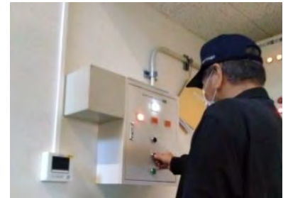
(写真6-2) 陽圧化装置の起動確認
