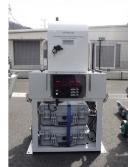
可搬型モニタリングポスト 【7台】 (バッテリー付)
