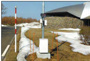
電子線量計【60局】 （非常用電源装備）
