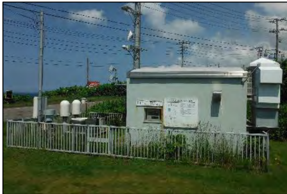
モニタリングステーション・ポスト【22局】 （非常用発電機装備）
