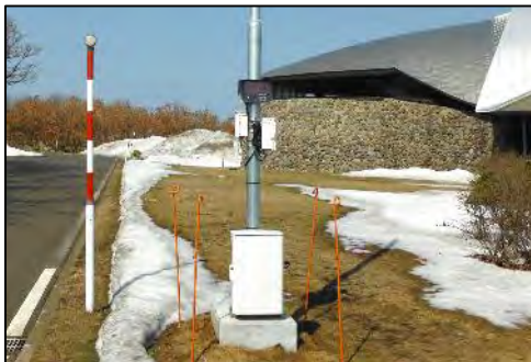
電子線量計【60局】 （非常用電源装備）
