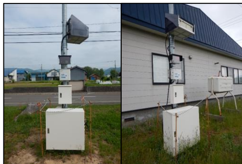
電子線量計【60局】 （非常用電源装備）
