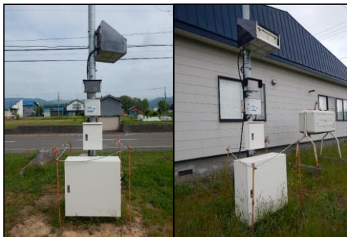
電子線量計【60局】 （非常用電源装備）
