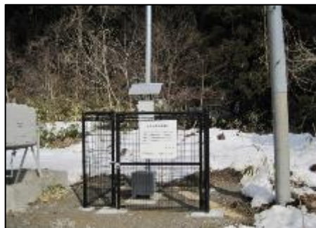
電子式線量計【42局】 （非常用電源装備）
