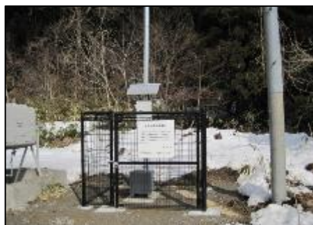
電子式線量計【1局】 （非常用電源装備）
