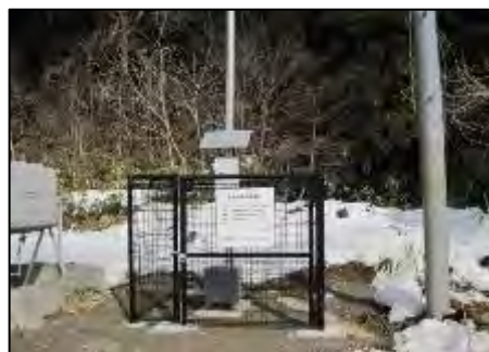
電子式線量計【42局】 （非常用電源装備）
