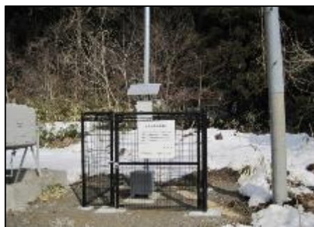
電子式線量計【1局】 （非常用電源装備）
