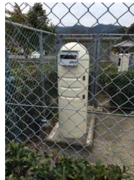
簡易型電子線量計観測局【55局】 (バッテリー付)
