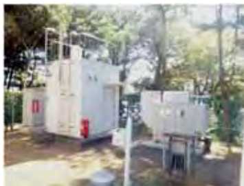
モニタリングステーションと 非常用発電機
