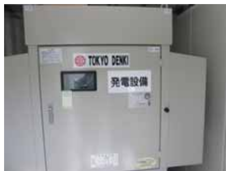
非常用電源装備(モニタリングステーション)
