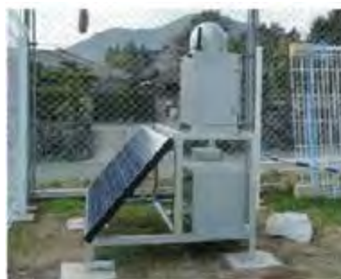
モニタリングポスト【25局】 (ソーラ発電装備)
