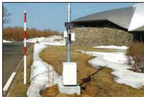
電子線量計【51局】 （非常用電源装備）
