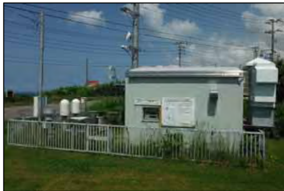
モニタリングステーション・ポスト【13局】 （非常用発電機装備）
