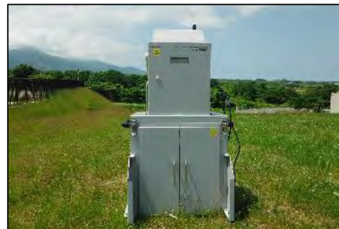
可搬型 モニタリングポスト【26台】
