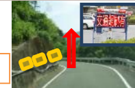
誘導標識の設置等
